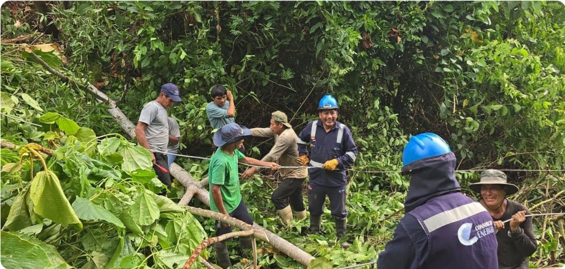
Restablecimiento de energía en la Provincia de Manu después de accidente en la zona por climas adversos.
