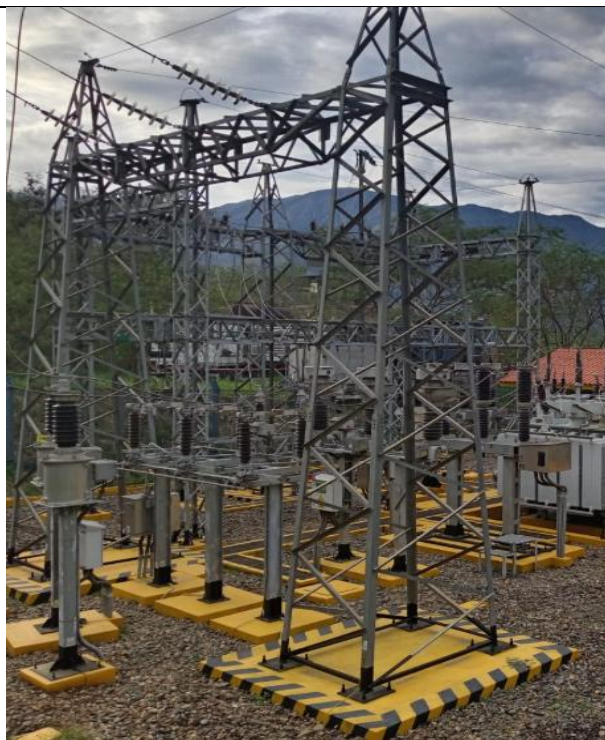
Zona de abandono parcial – patio de llaves a desmontar
