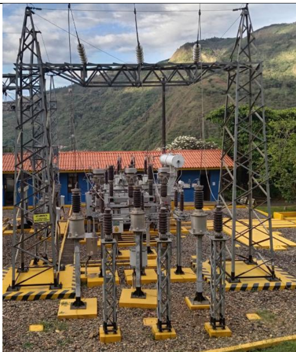
Zona de abandono parcial – patio de llaves a desmontar
