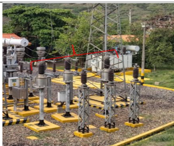
Transformadores de tensión capacitivo de 72.5 kV
