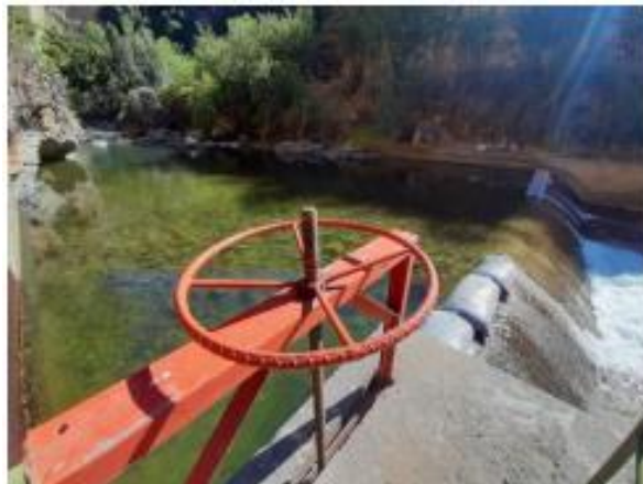
Figura N°7 : Bocatoma C.H. Vilcabamba
