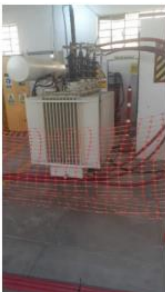
Figura N°5 : Transformador C.H. Vilcabamba
