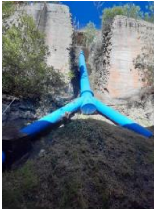
Figura N°11 : Tubería de Presión C.H. Vilcabamba
