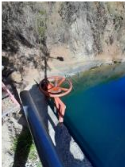
Figura N°10 : Cámara de Carga C.H. Vilcabamba
