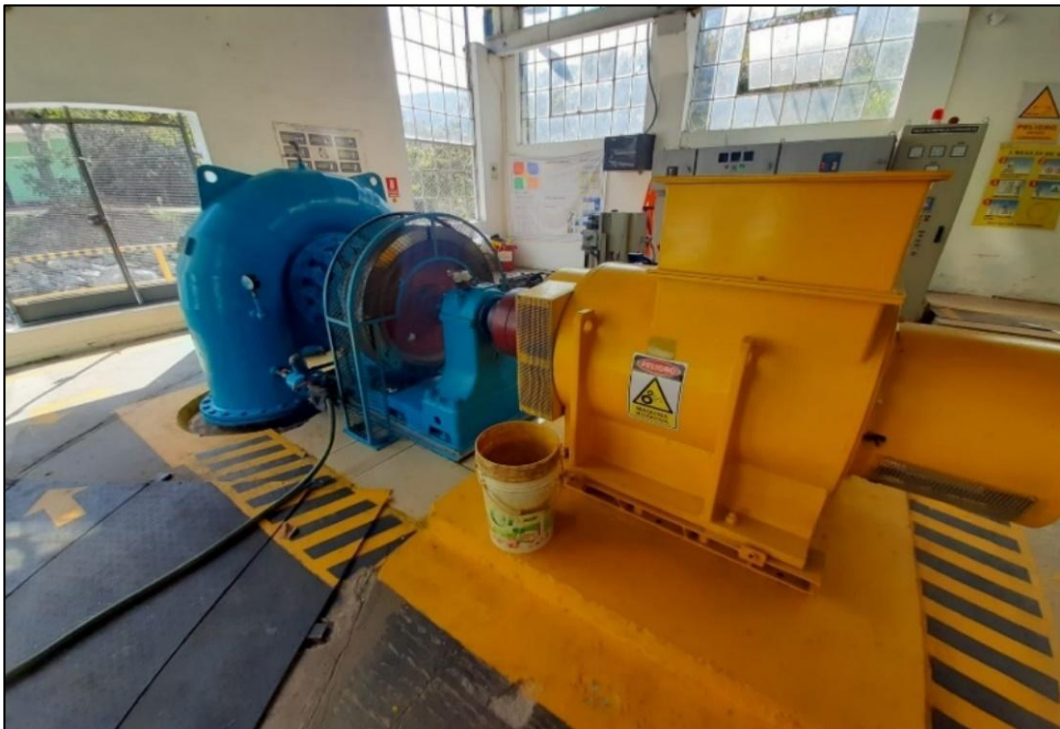
Figura N°3: Grupo generador G1 – C.H Chuyapi
