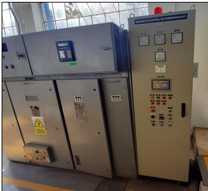
Figura N°5: Tablero de control
