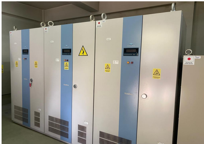
Ilustración N° 3 Tablero de control del S.F. Instalaciones Sede de Electro Sur Este S.A.A
