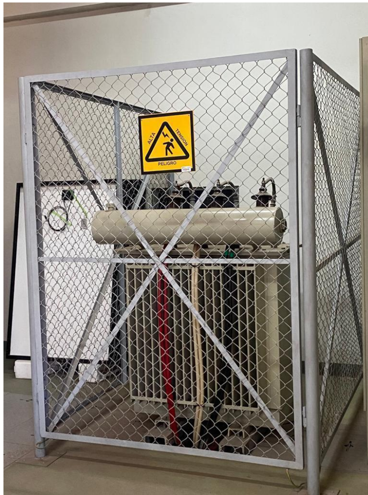
Ilustración N° 4 Transformador de potencia
