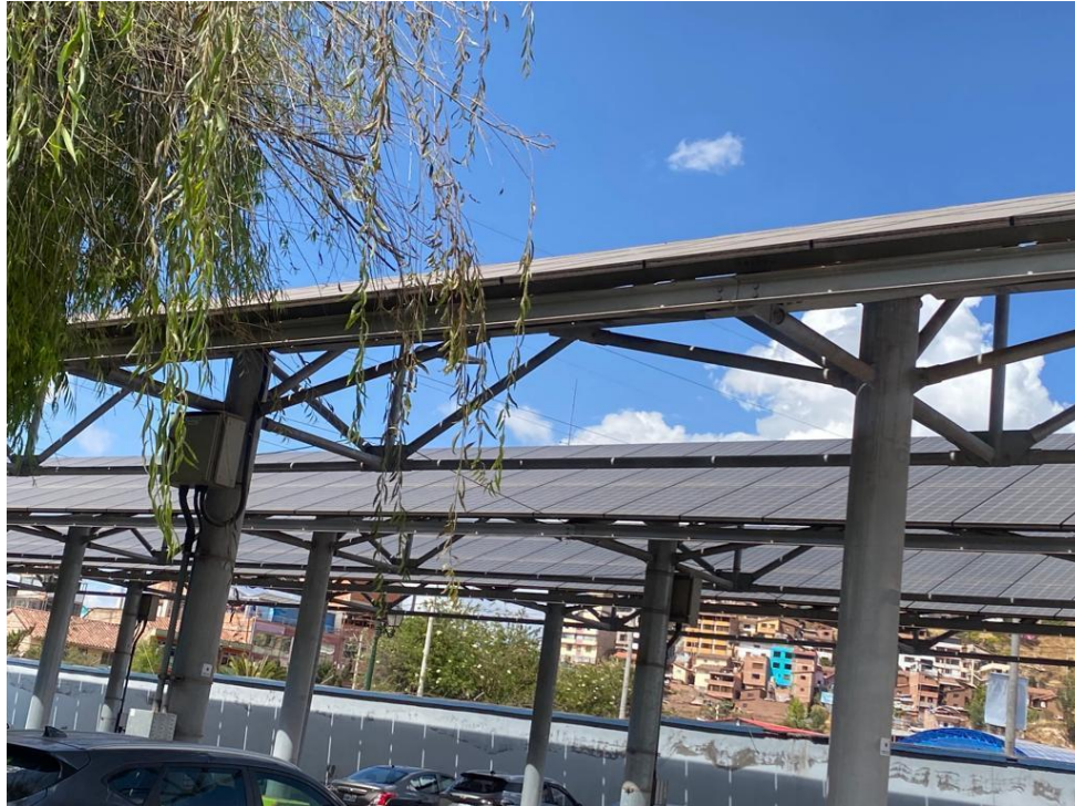
Ilustración N° 1 Paneles solares en la zona del estacionamiento
