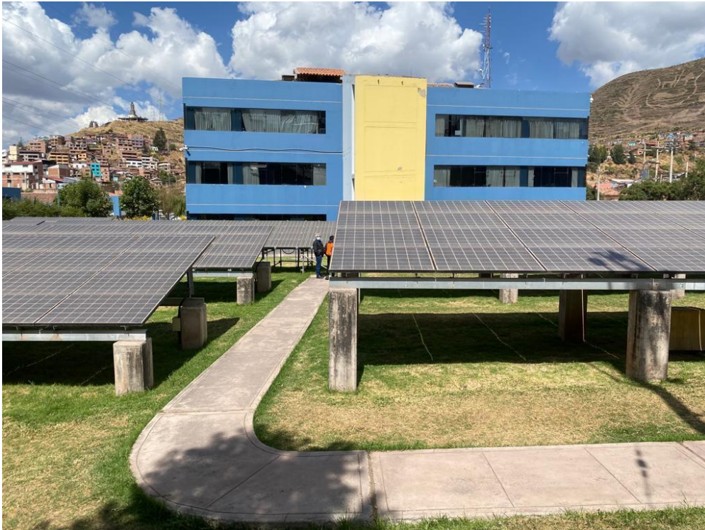
Ilustración N° 2 Paneles solares la parte posterior de las instalaciones de ELSE
