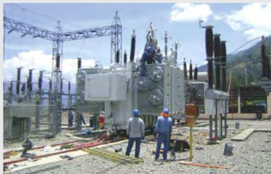
Nueva sub estación de Tamburco - Abancay
